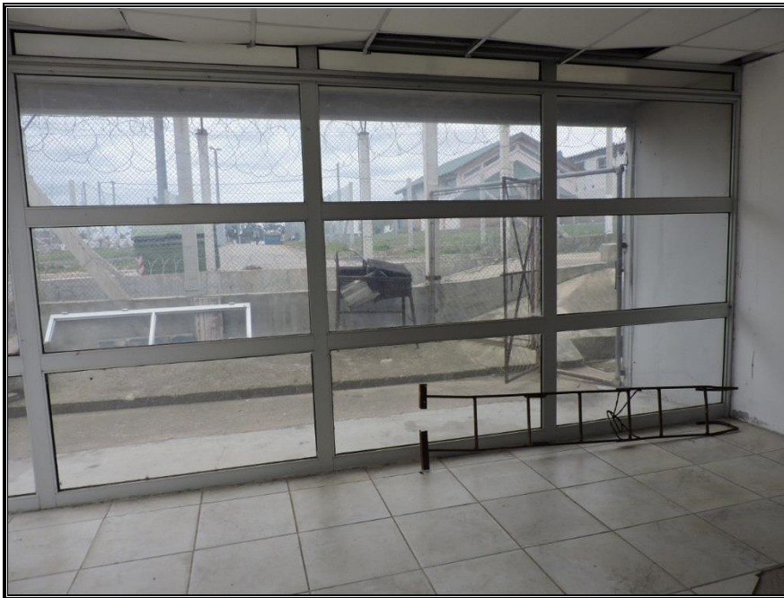
Foto 3. Módulo 12, Estado perímetro exterior. Registro Fotográfico 6 de setiembre de 2019
