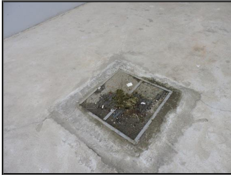
Foto 10. Registro Fotográfico 6 de setiembre de 2019 – Aserrín y otros desperdicios depositados en el alcantarillado del Patio
