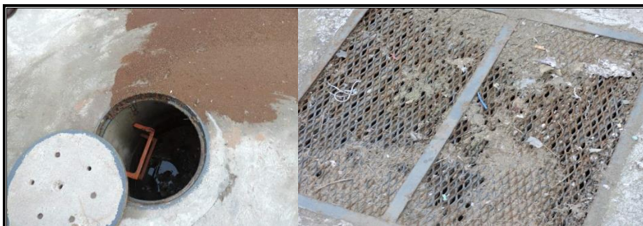
Foto 8. Registro Fotográfico 20 de abril de 2016 Foto 9. Registro Fotográfico 6 de setiembre de 2019 – Aserrín depositado en el alcantarillado.
