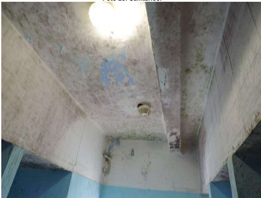
Foto 26: Estado de techos y paredes.
