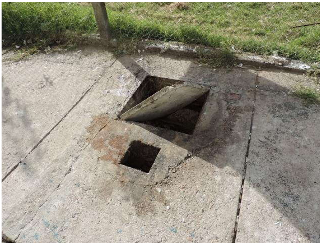
Foto 51: Corredor del fondo del Centro, detalle del estado de las cámaras sépticas.
