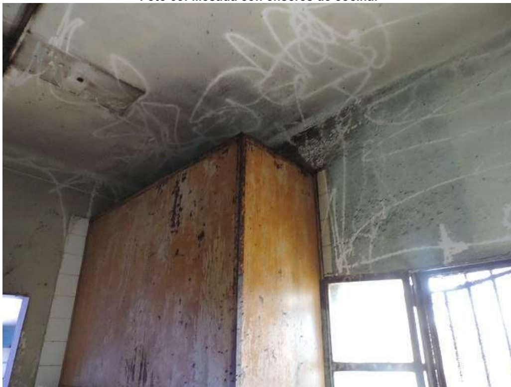
Foto 34: Estado de techo de cocina.
