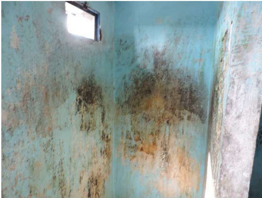
Foto 27: Estado de techos y paredes.
