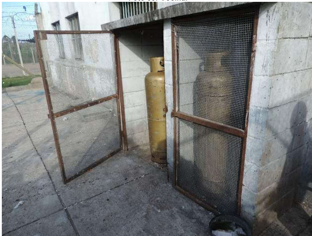
Foto 36: Jaula para garrafas de gas en el exterior de la cocina.
