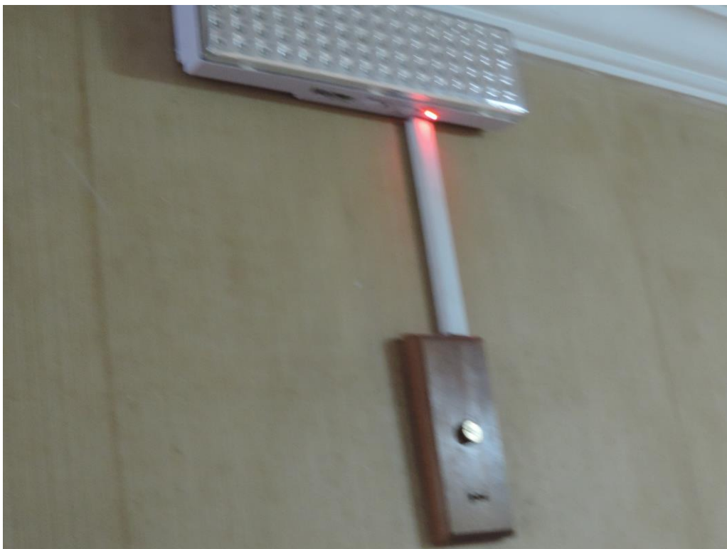
Foto 10: Luz de emergencia en pasillo de dormitorios de adolescentes mujeres.
