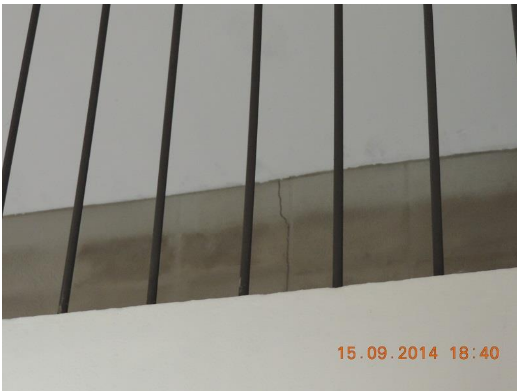
Foto 26: grieta en celdario
