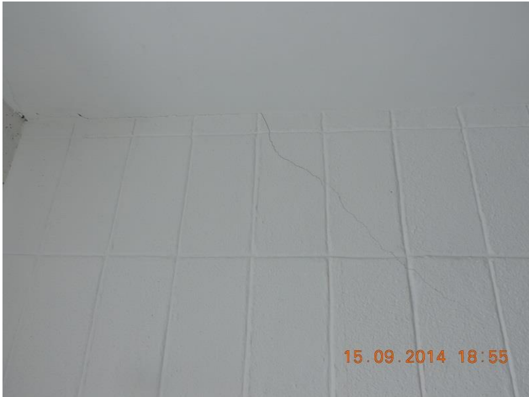
Foto 33: grieta en sala educadores
