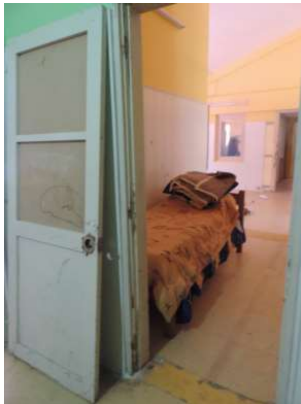
Foto 35: Puerta para arreglar
