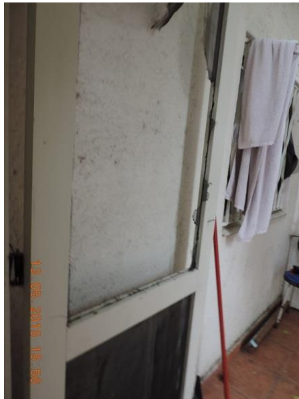
Foto 31: Abertura sin vidrio
