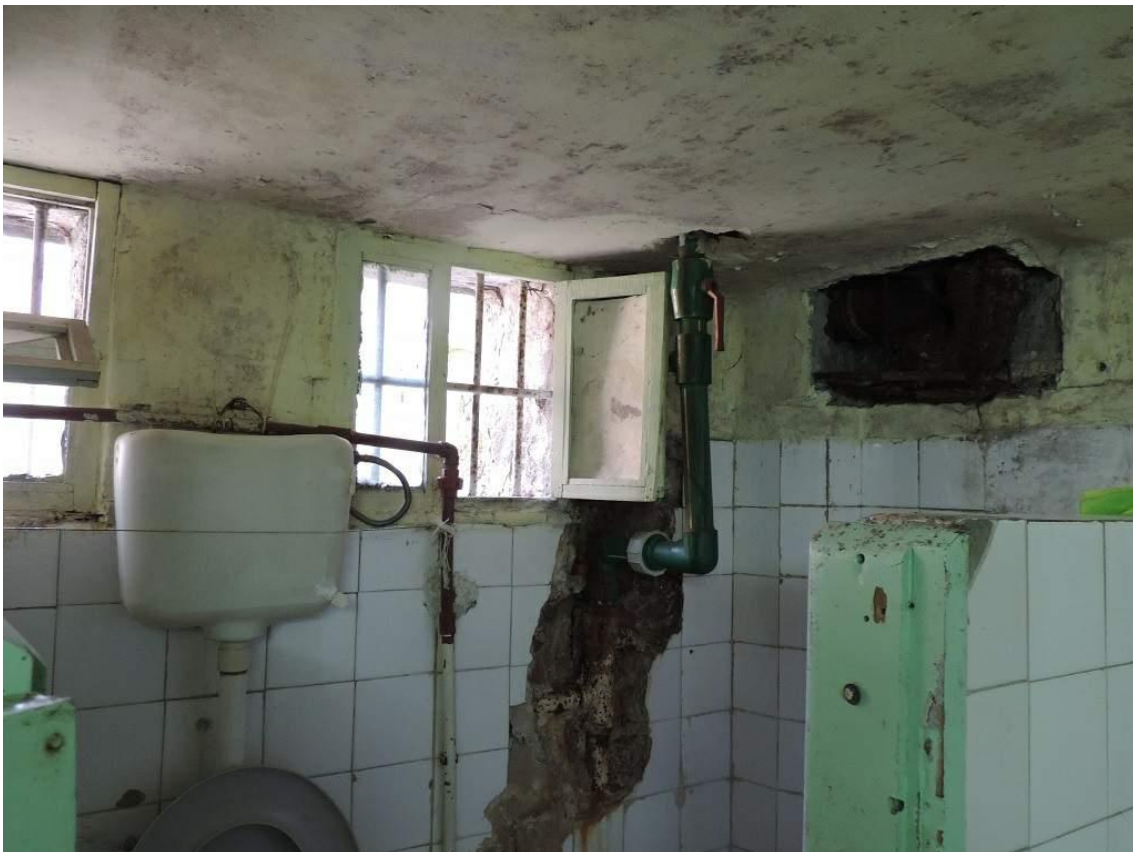
Foto 12: Instalaciones sanitarias 6to piso "A"
