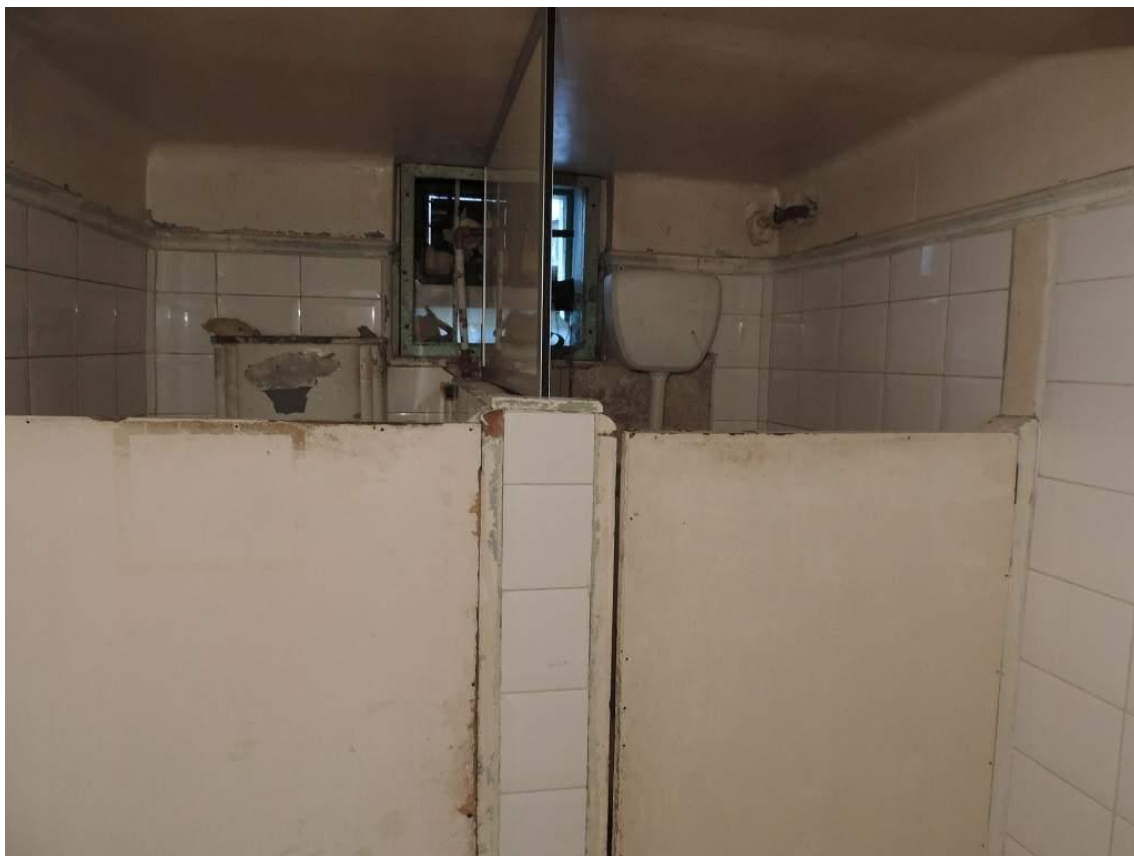
Foto 24: Instalaciones sanitarias 4to piso
