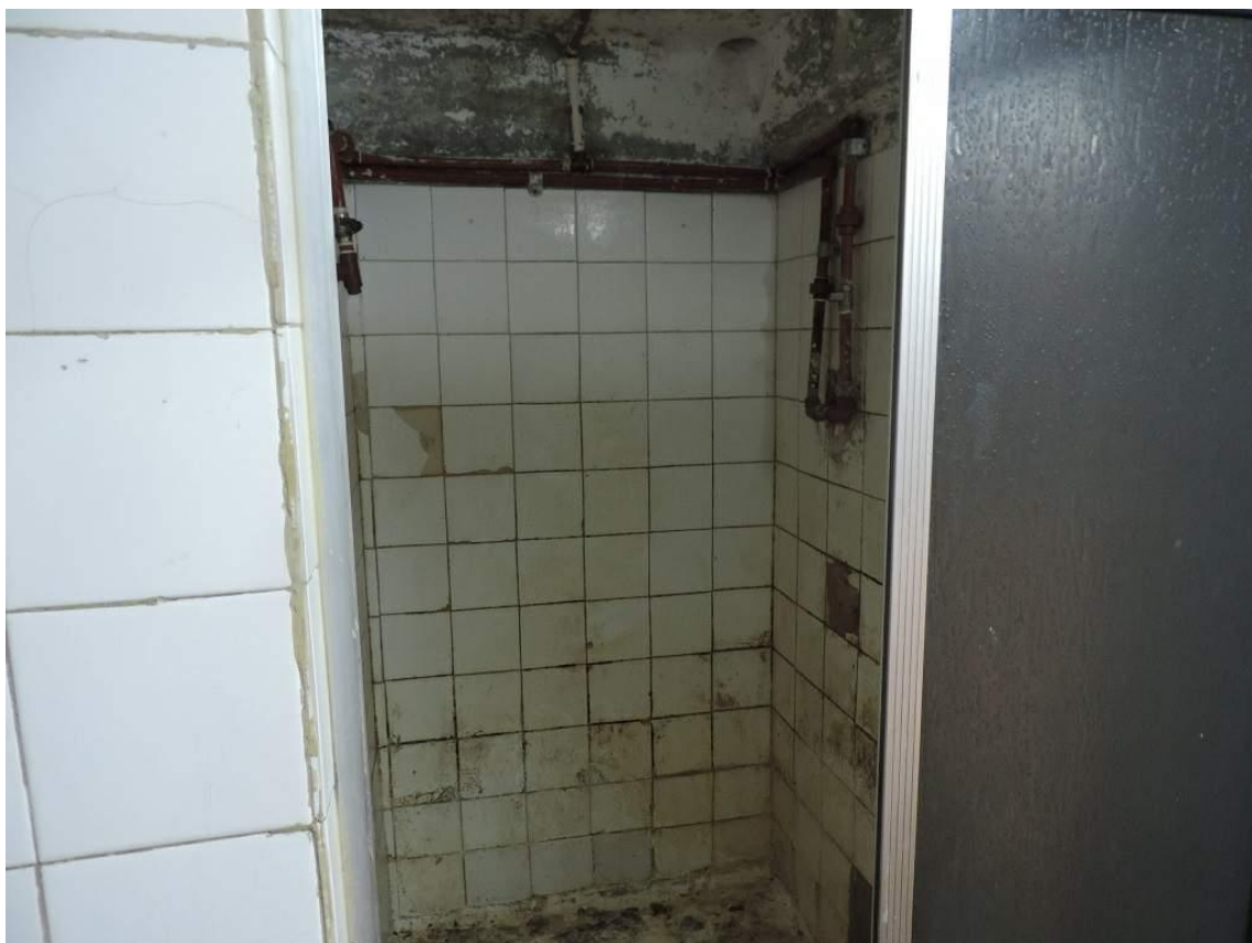
Foto 27: Instalaciones sanitarias 4to piso
