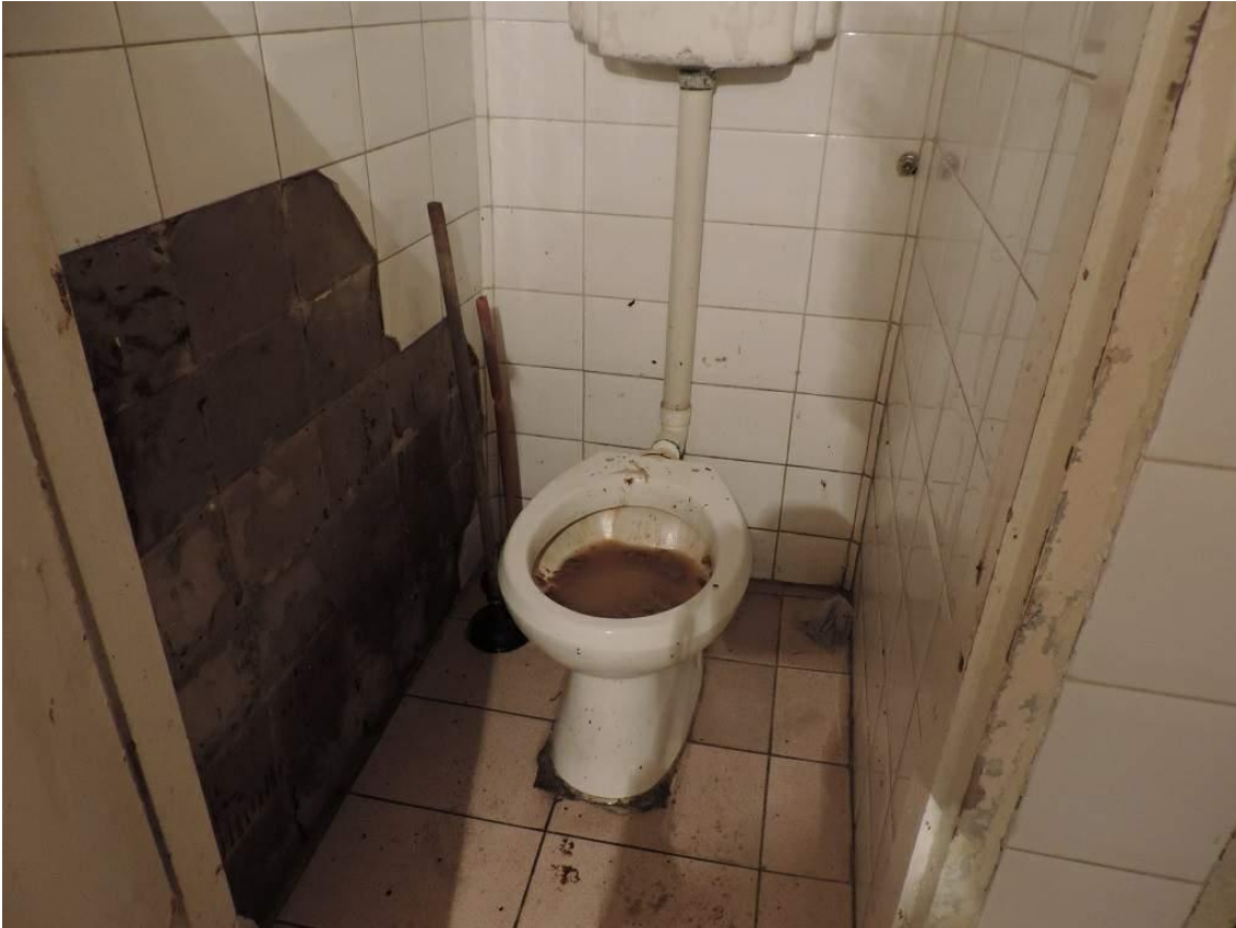
Foto 25: Instalaciones sanitarias 4to piso
