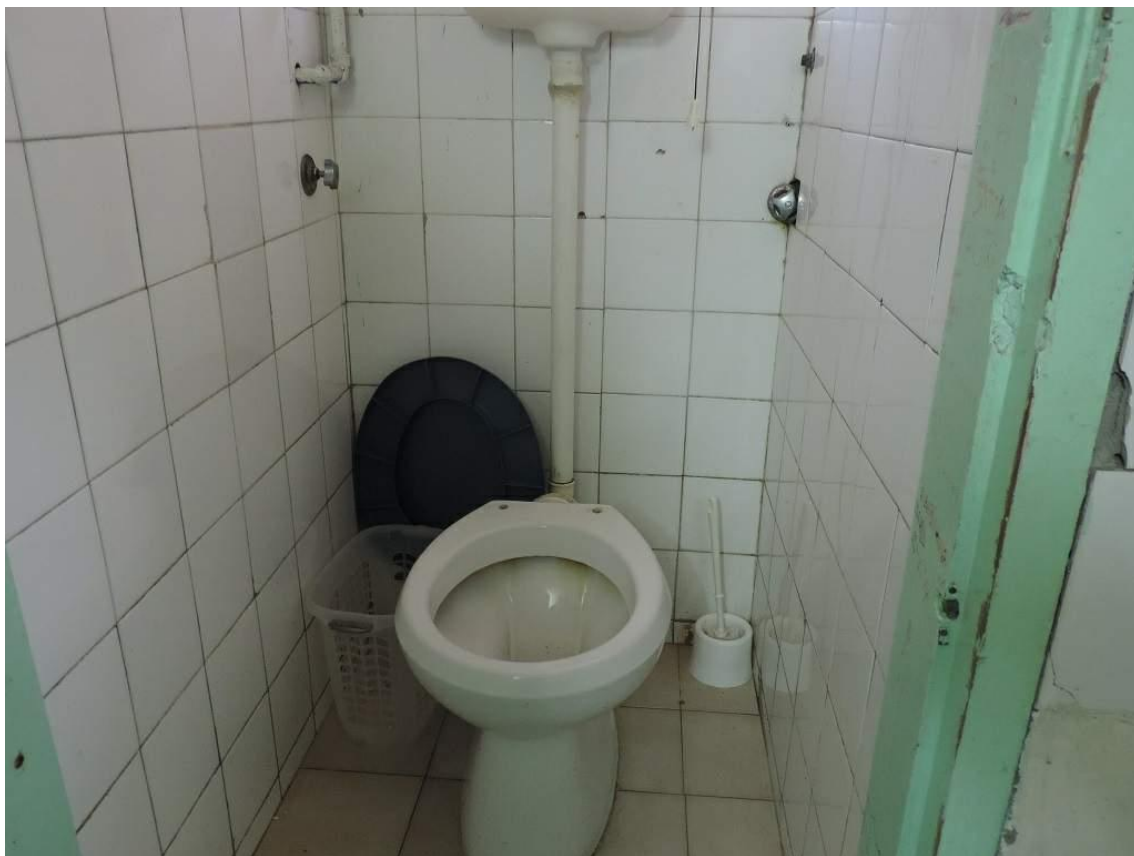
Foto 14: Instalaciones sanitarias 6to piso "A"
