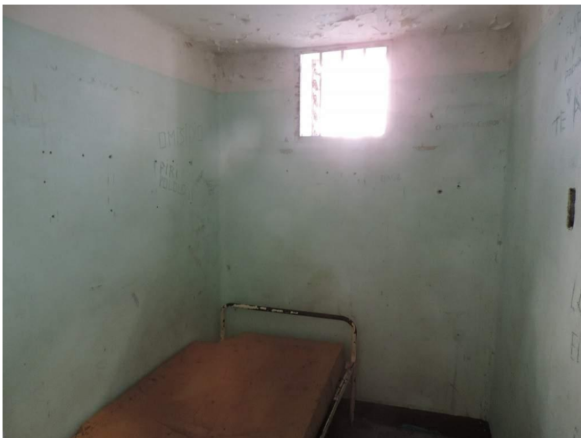
Foto 20: Celda 4to piso
