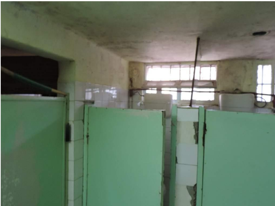
Foto 10: Instalaciones sanitarias 6to piso "A"
