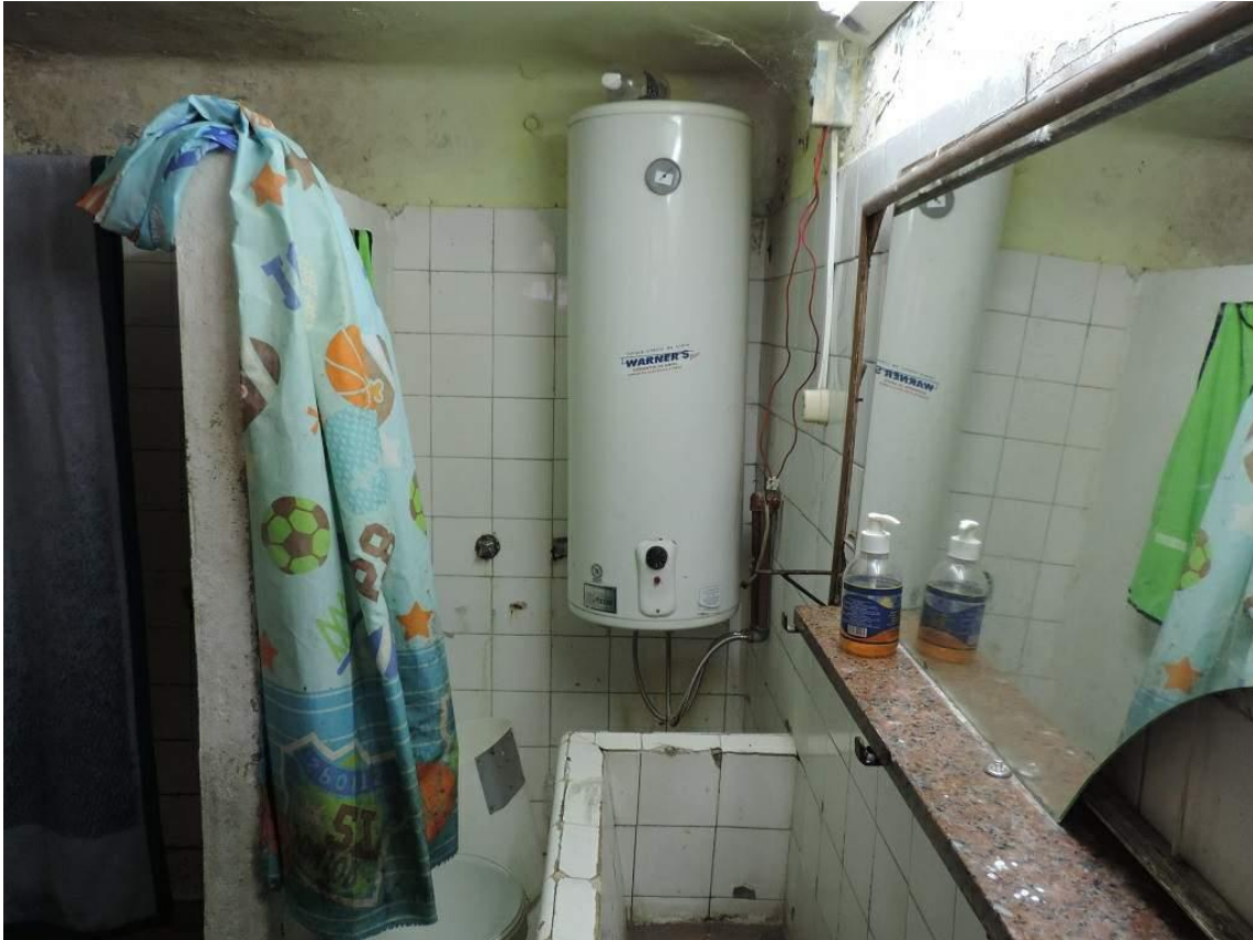
Foto 9: Instalaciones sanitarias 6to piso "A"
