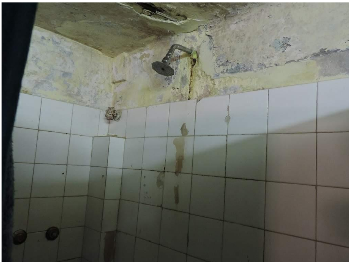
Foto 13: Instalaciones sanitarias 6to piso "A"
