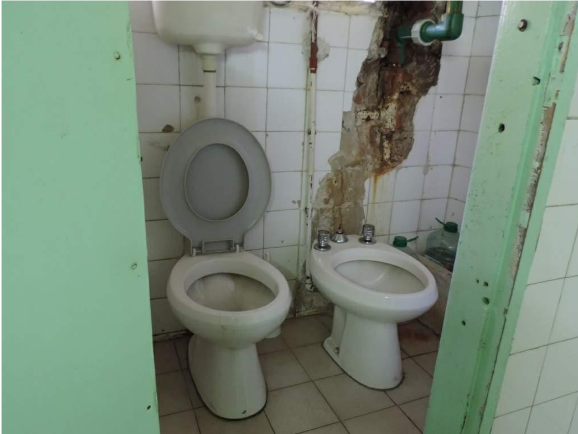
Foto 11: Instalaciones sanitarias 6to piso "A"
