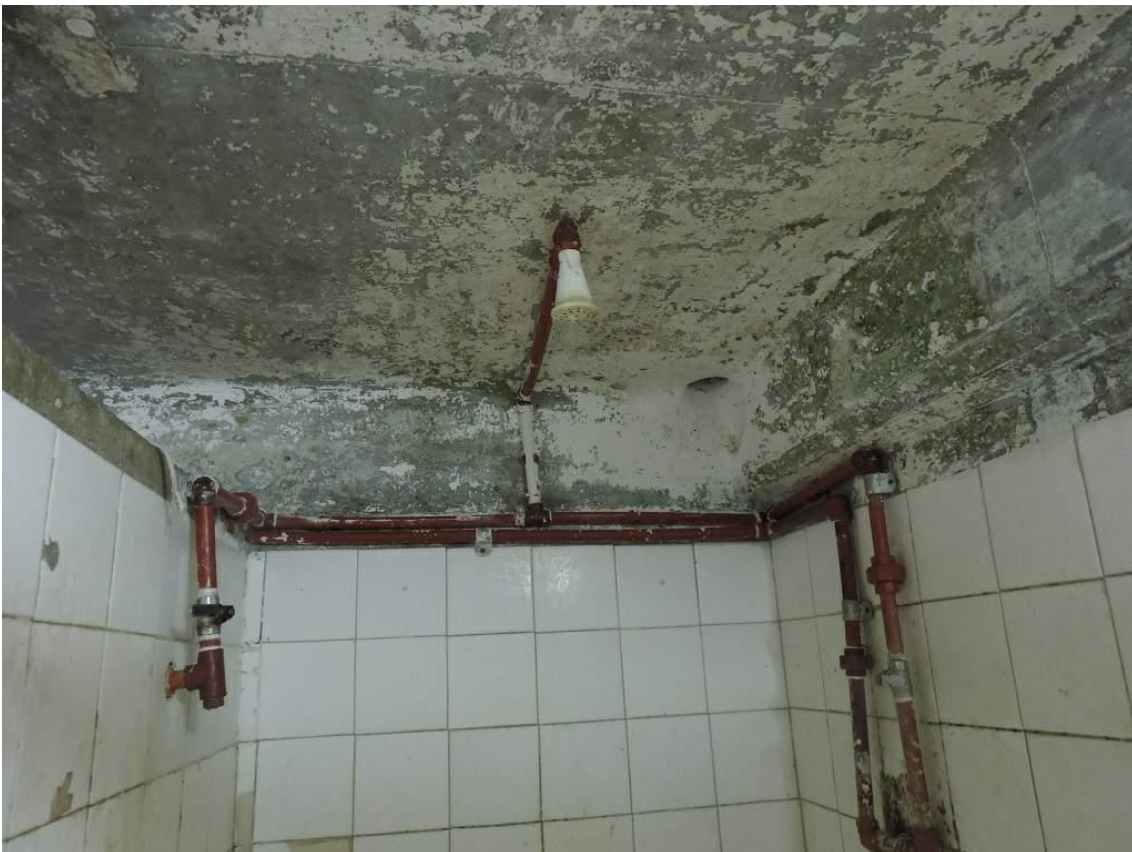
Foto 26: Instalaciones sanitarias 4to piso
