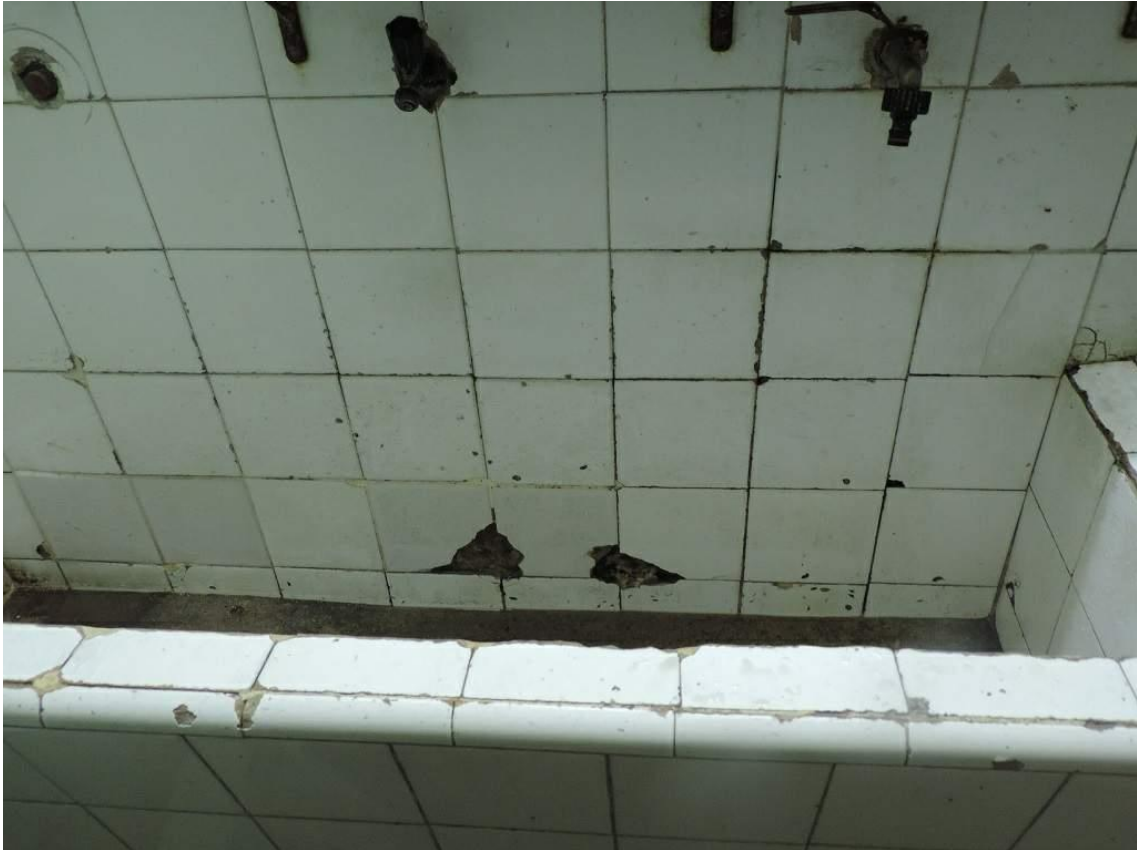
Foto 15: Instalaciones sanitarias 6to piso "A"
