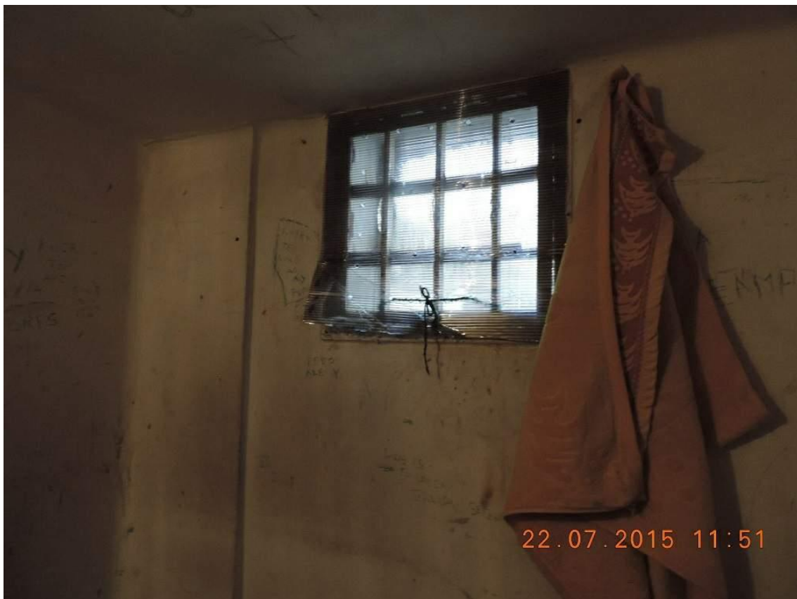
Foto 34: Protección de plástico colocada en ventanas sin vidrios
