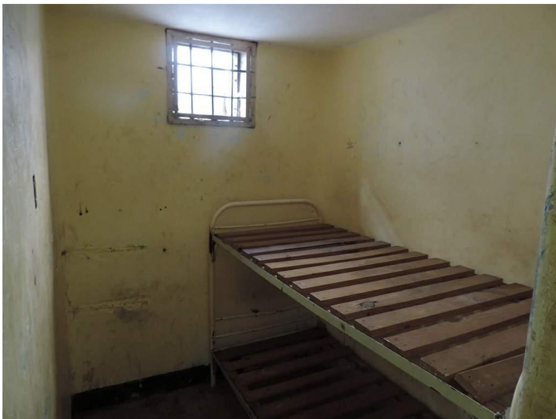
Foto 23: Celda 4to piso
