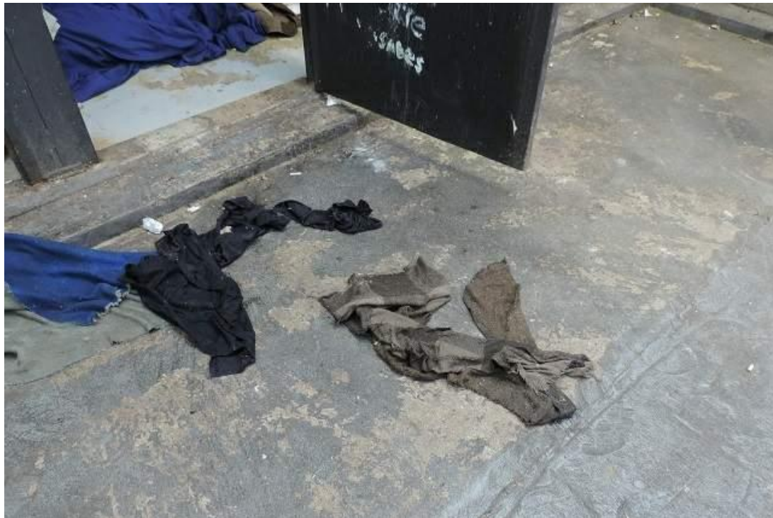
Foto 8: Trapos utilizados para detener las filtraciones de los combinados sanitarios
