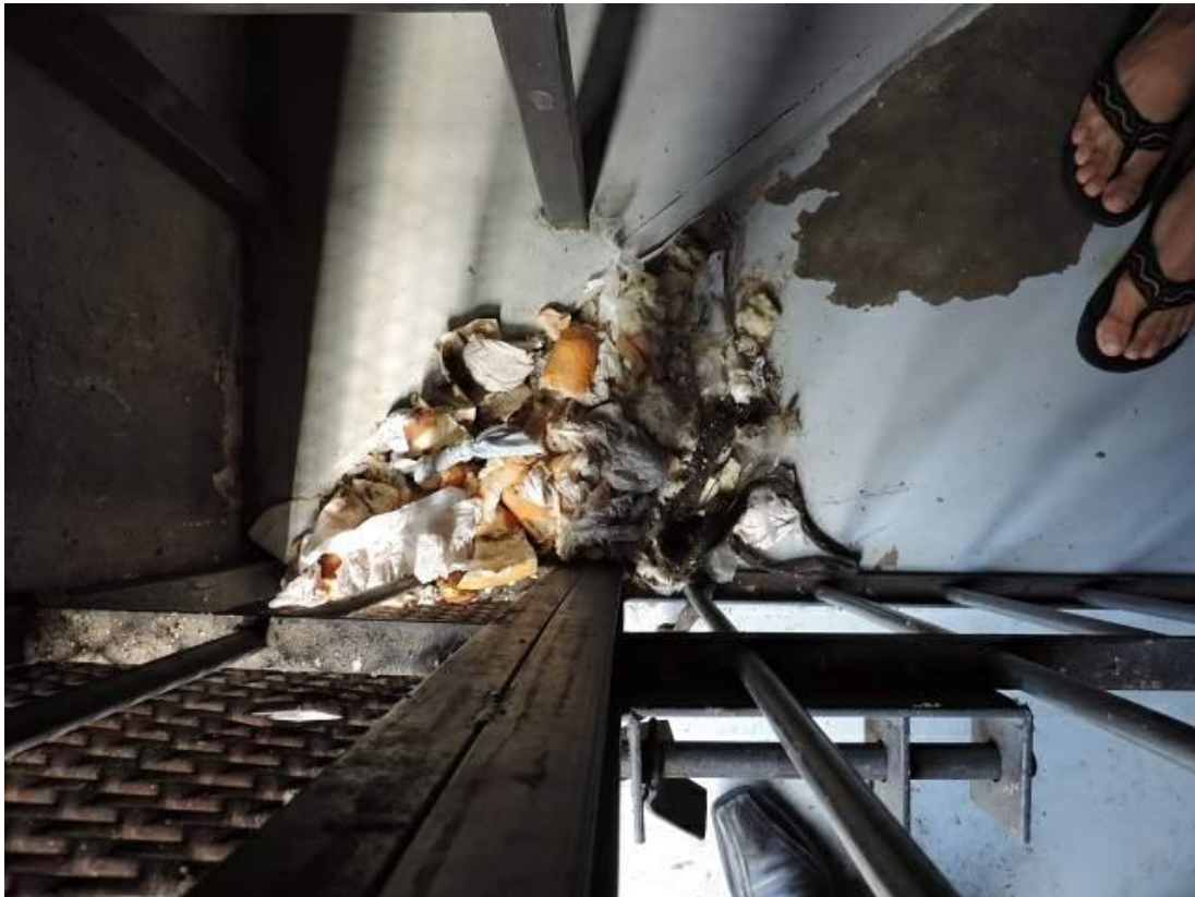
Foto 9: Residuos amontonados en el interior de una celda
