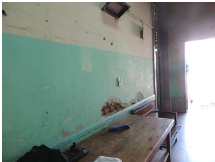
Foto N° 14: deterioro en paredes del comedor
