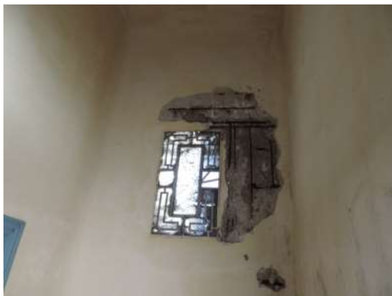
Foto N° 16: Ventana interior con paredes deterioradas
