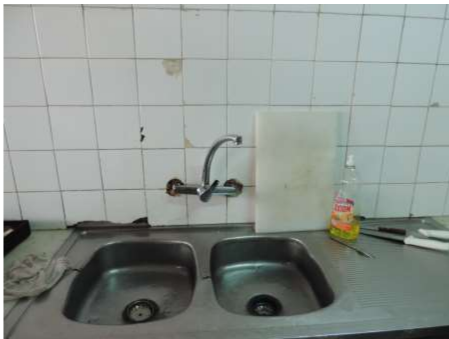
Foto N° 15: Piletas de cocina
