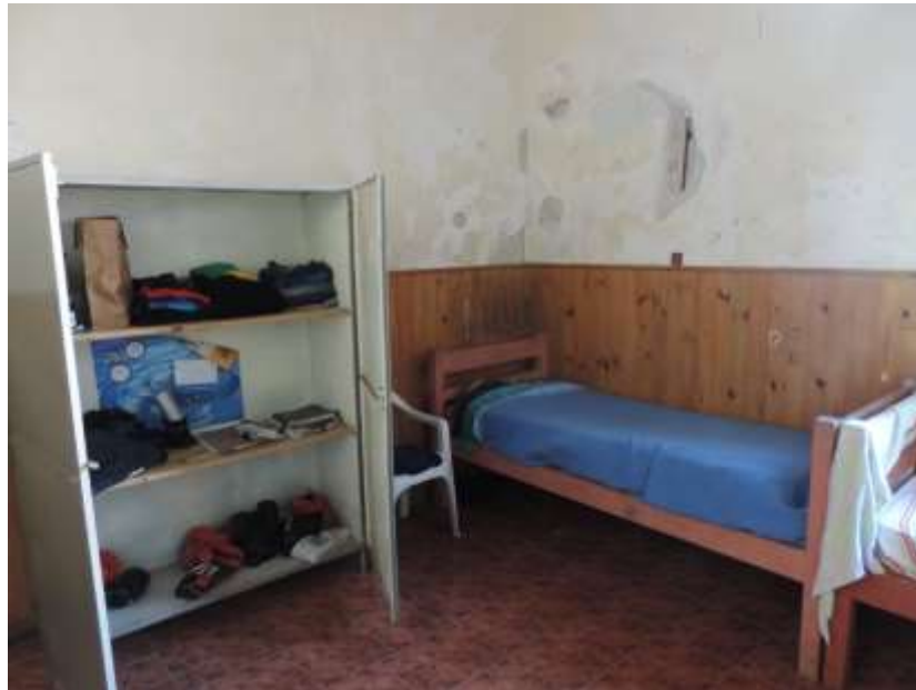
Foto N° 11: deterioro en paredes de dormitorio de jóvenes
