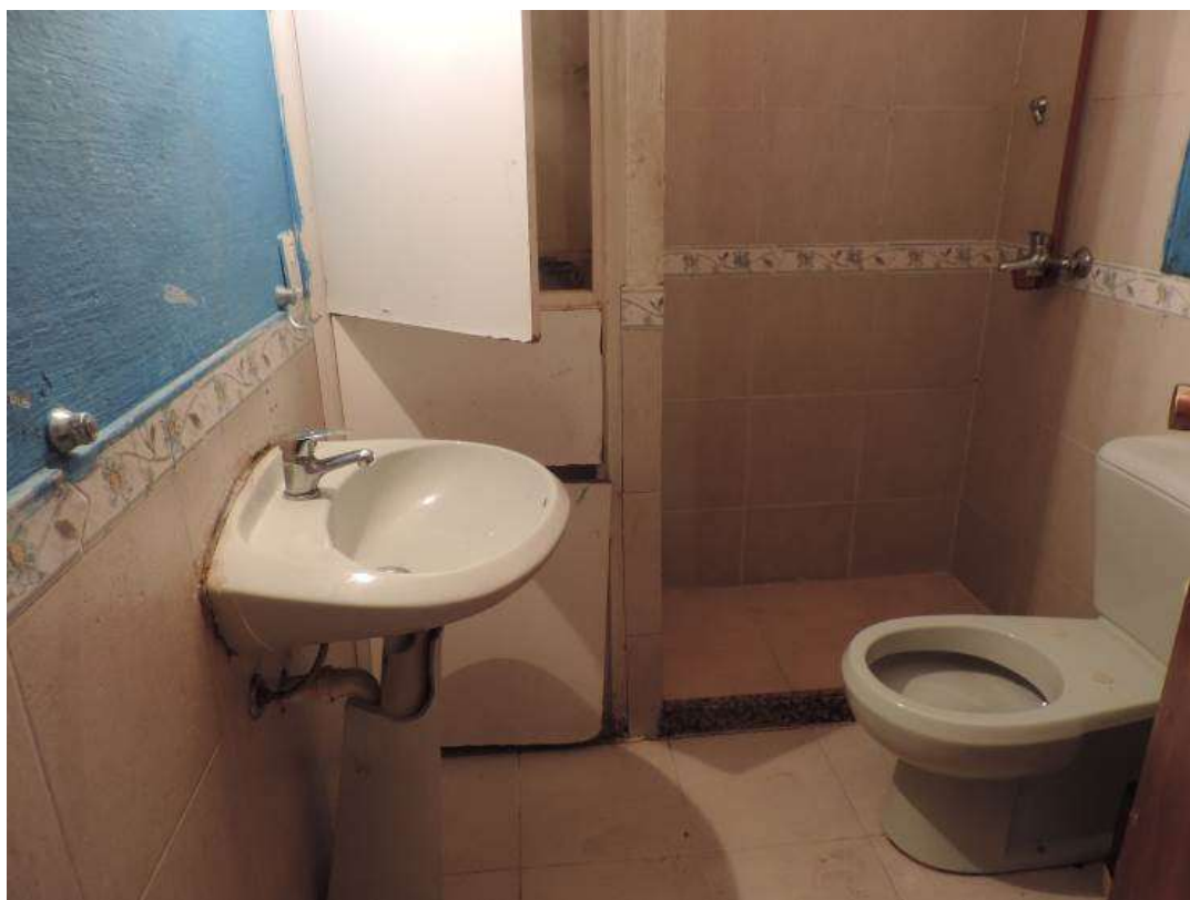
Foto Nº 4: Baños: sin espejo, y pie de lavabo con roturas
