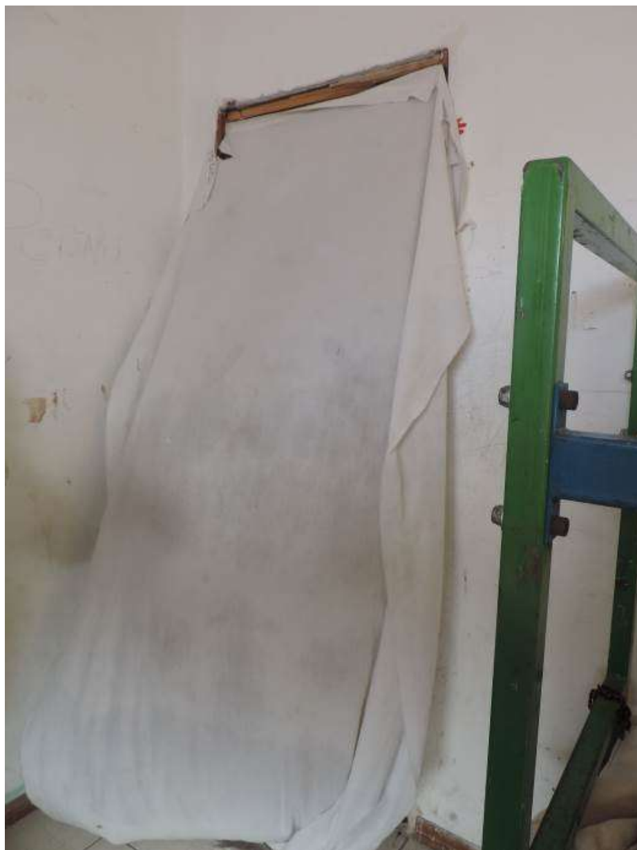
Foto N° 1: Puerta sustituida por sábanas en Dormitorio de varones
