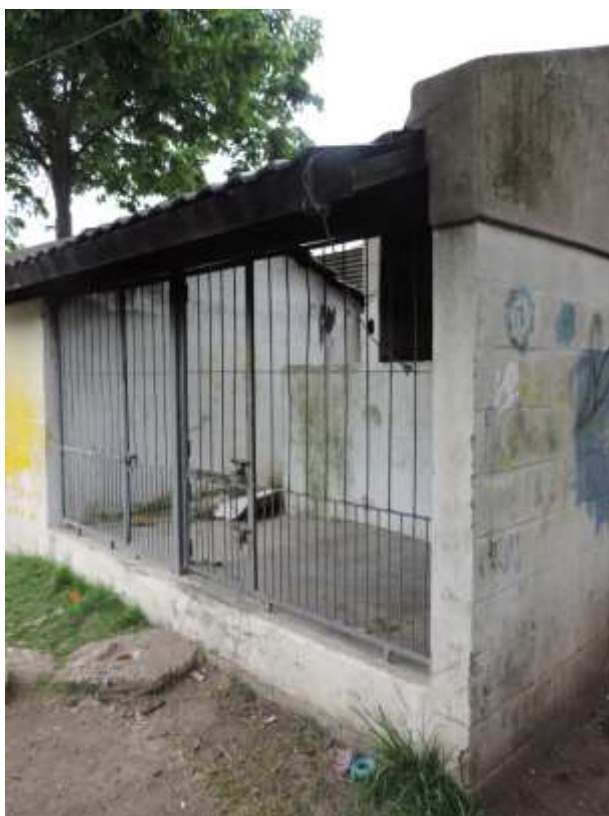
Foto 16: Construcción vandalizada en el fondo
