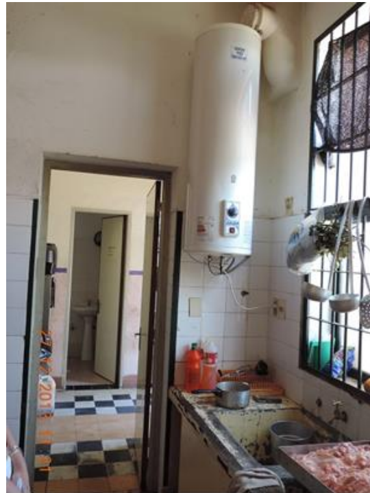
Foto 17: Instalaciones de la cocina del centro
