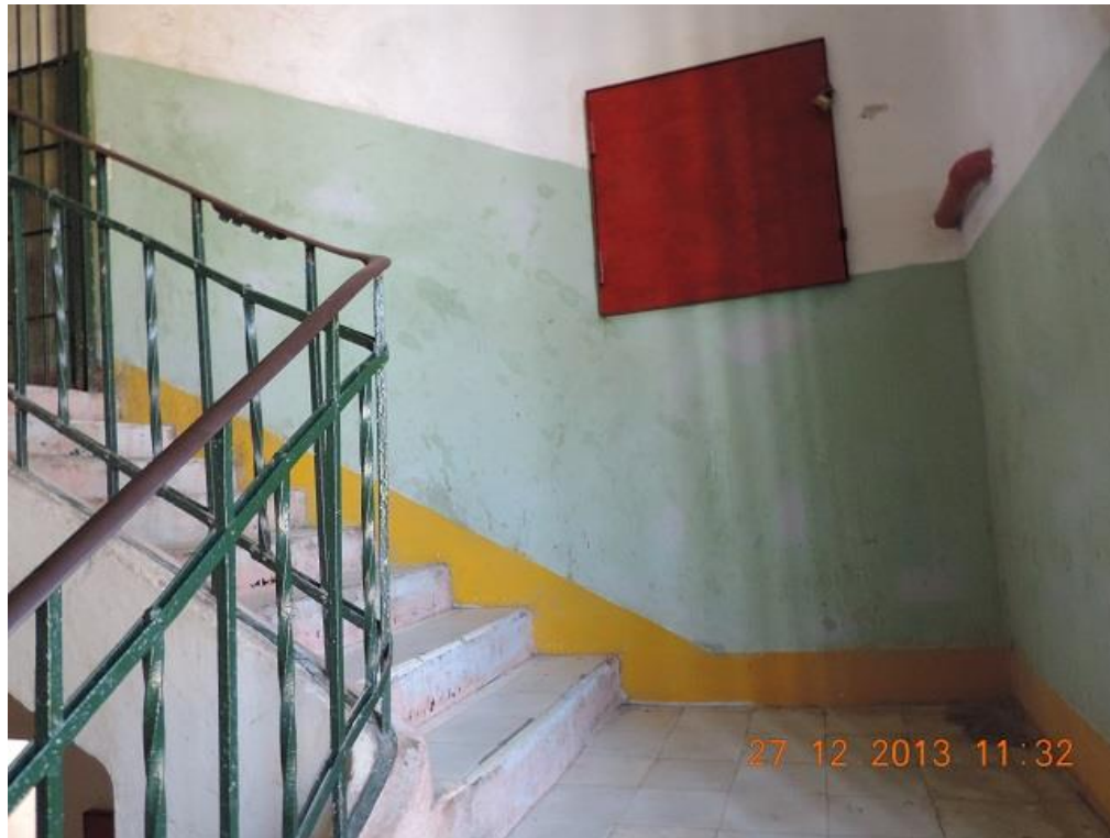
Foto 41: Escalera de acceso al celdario, boca de incendio en la misma
