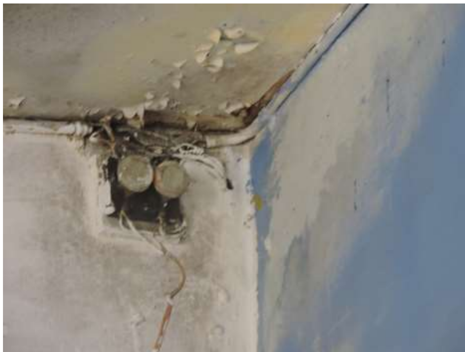
Foto 5: Estado de conservación/mantenimiento
