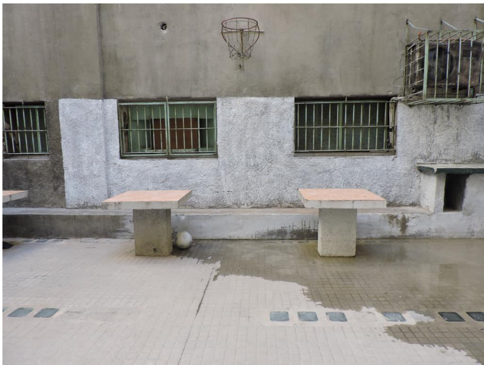
Foto 11 -Descripción: Patio con agua proveniente de pérdidas durante las acciones de reparación de la instalación sanitaria del edificio. Fecha de captura: 29/3/2022 - Registro fotográfico: equipo del MNP, 2022.
