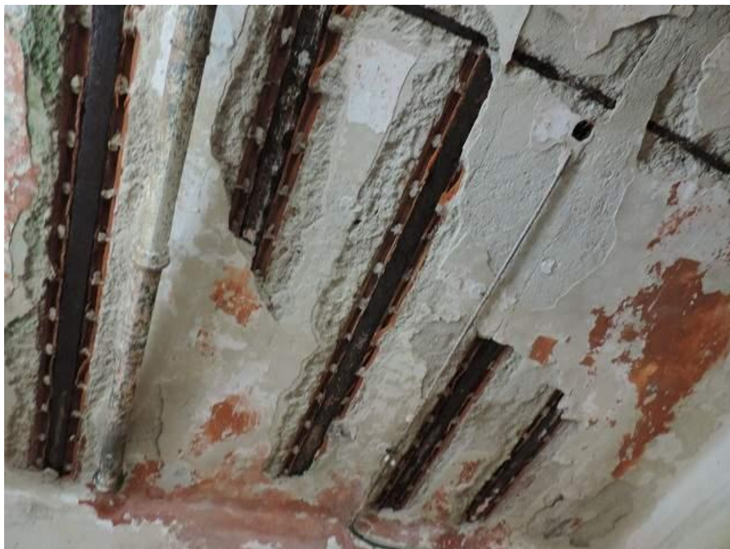
Foto 30: Estado de los techos del baño de gimnasio
