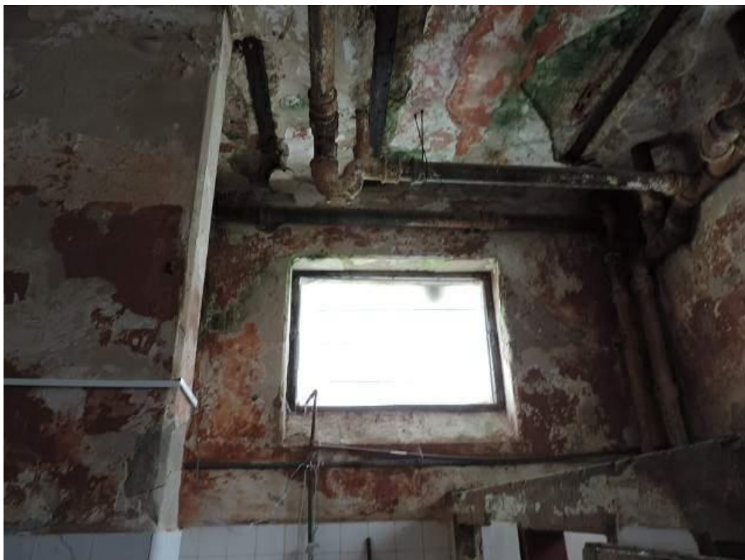
Foto 29: Estado de los techos del baño de gimnasio
