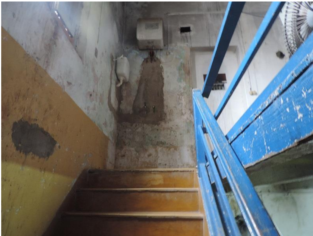
Foto 12-Cisterna baño planta alta
