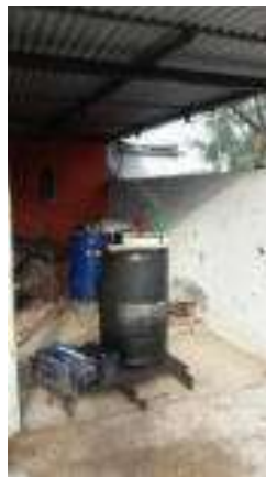
Fig.7. Vista tanques de lubricantes acondicionados bajo techo.
