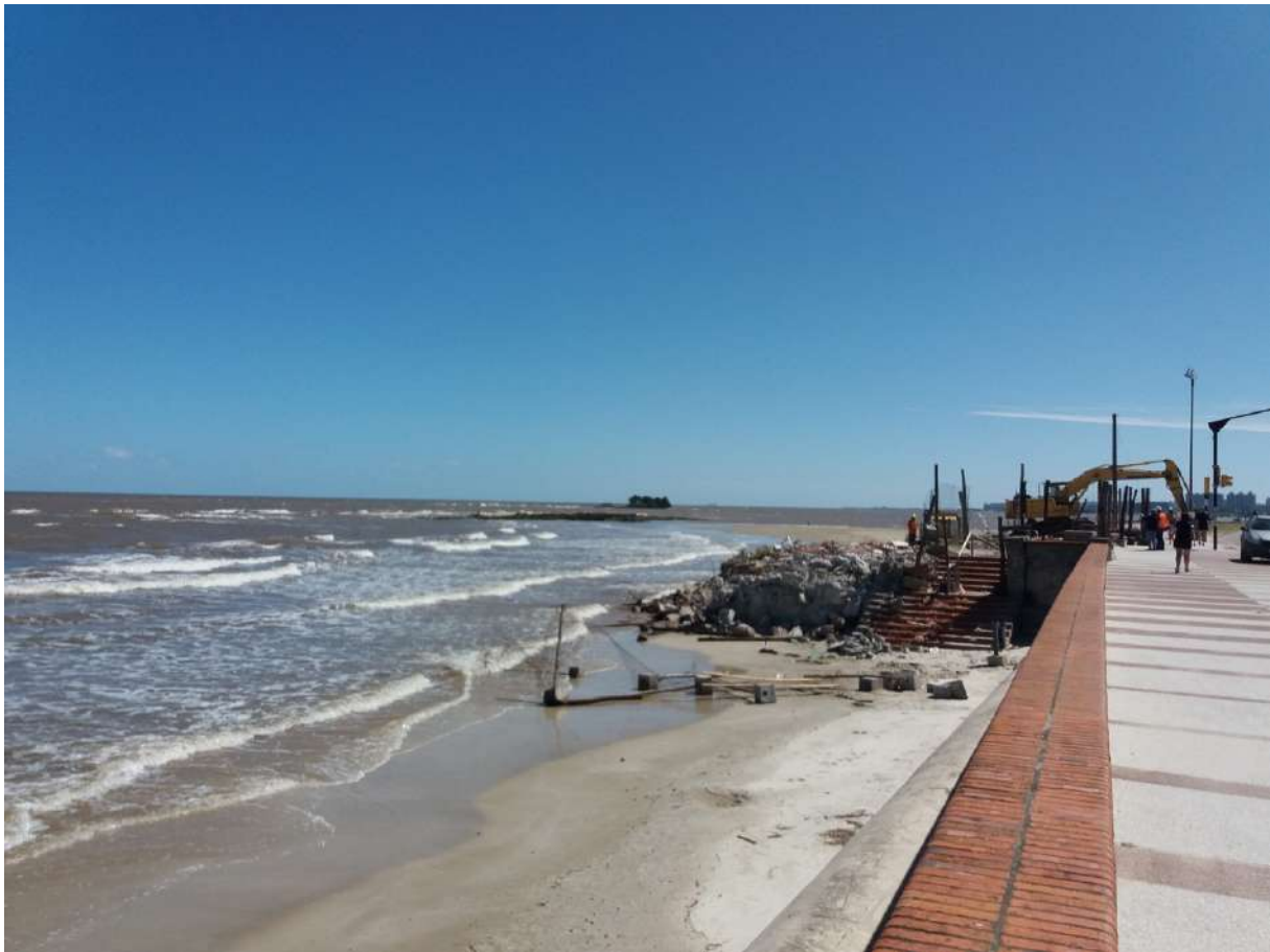
Figura 1. Playa Brava. Demolición de antiguo cine en la playa. Los problemas de erosión en esta playa se pretenden resolver con la instalación de geotubos rellenos de arena, colocados a modo de diques semisumergidos.
