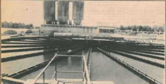
Las instalaciones de OSE trabajan a plena capacidad para el aumento del consumo y los picos que éste registra los días de verano hacen que el bombeo sea insuficiente. Según el organismo, sólo la construcción de la quinta línea permitirá superar estos problemas.
