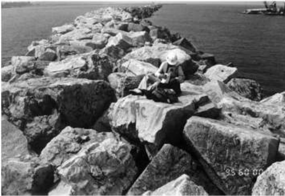
Figura 4-72 Ejemplo de enrocado colocado de forma aleatoria (Figure VI-4-2 del Coastal Engineering Manual).
