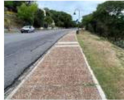
Zona en que el agua de la calle desborda y erosiona el talud (Rambla y calle Italia)
