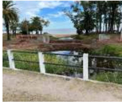
Descarga pluvial (calle Manuel Caballero)
