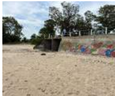
Descarga Pluvial (calle Eloy Perazza)
