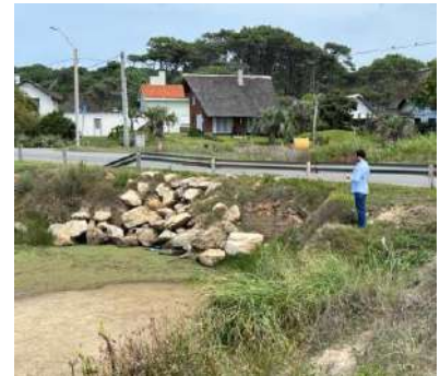
Alcantarilla obstruida en la descarga en la playa
