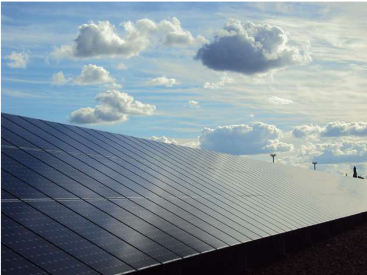
Planta de energía solar fotovoltaica de ASAHI, Salto.
