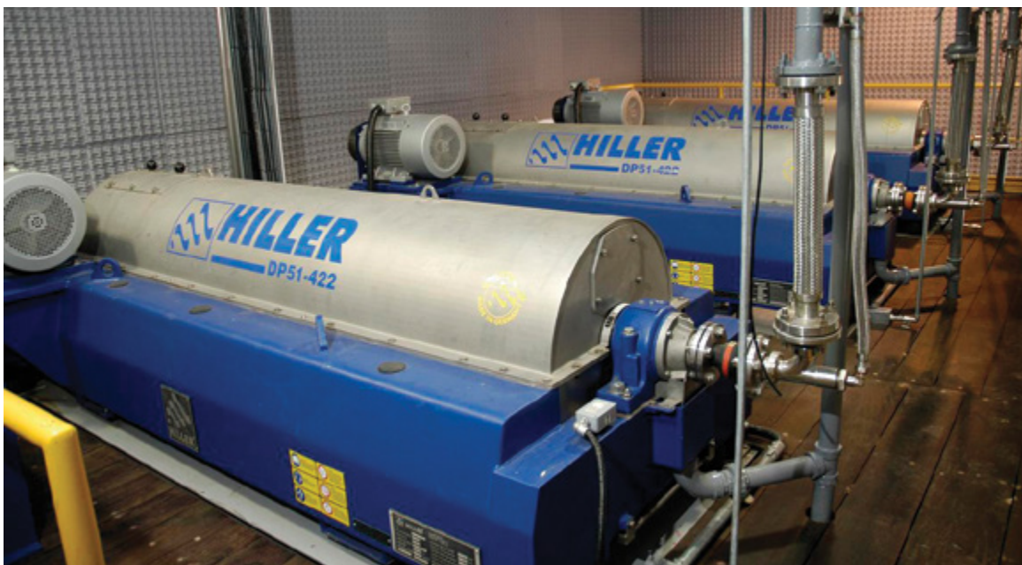
Decantadores centrífugos para deshidratación de sólidos. Foto: Proyecto FREPLATA.
