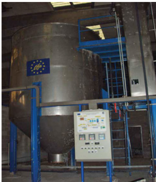
Instalación para la recuperación de los baños de curtido. Foto: AUQTIC.
