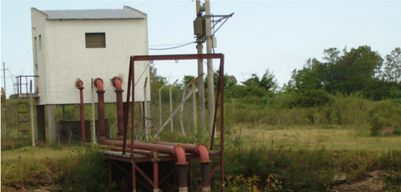
Figura 8.30. Toma directo – típica de bombeo – Fotografía DINAGUA
