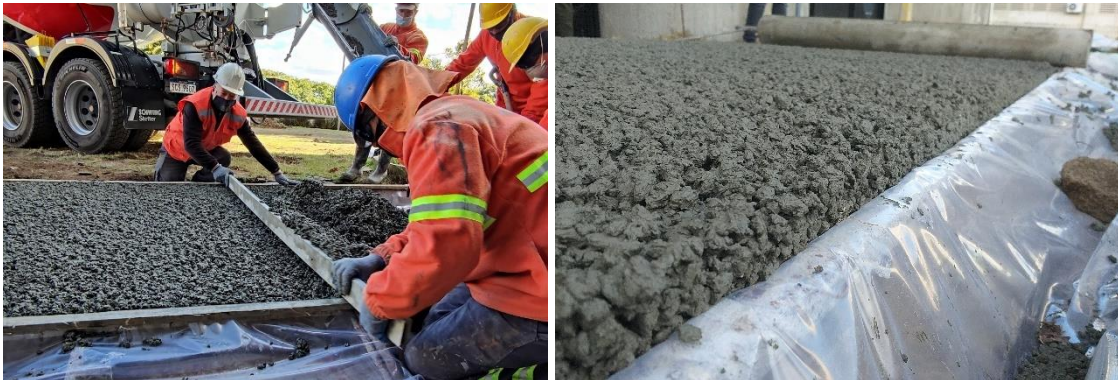
Figura 25. Nivelación con sobrealtura y aspecto previo a la compactación luego de retirar listón.
