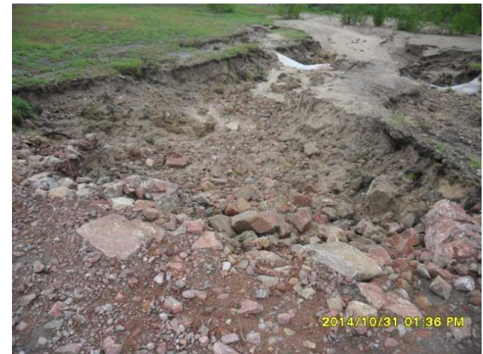
Daños de erosión por lluvia
