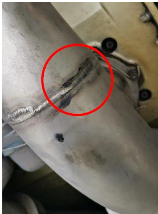
Imagen 4. Detalle de la fisura cercana a la soldadura.
