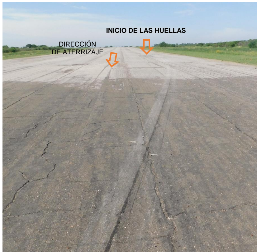
Imagen 6. Inicio de las huellas de la hélice contra el pavimento de la pista 02.
