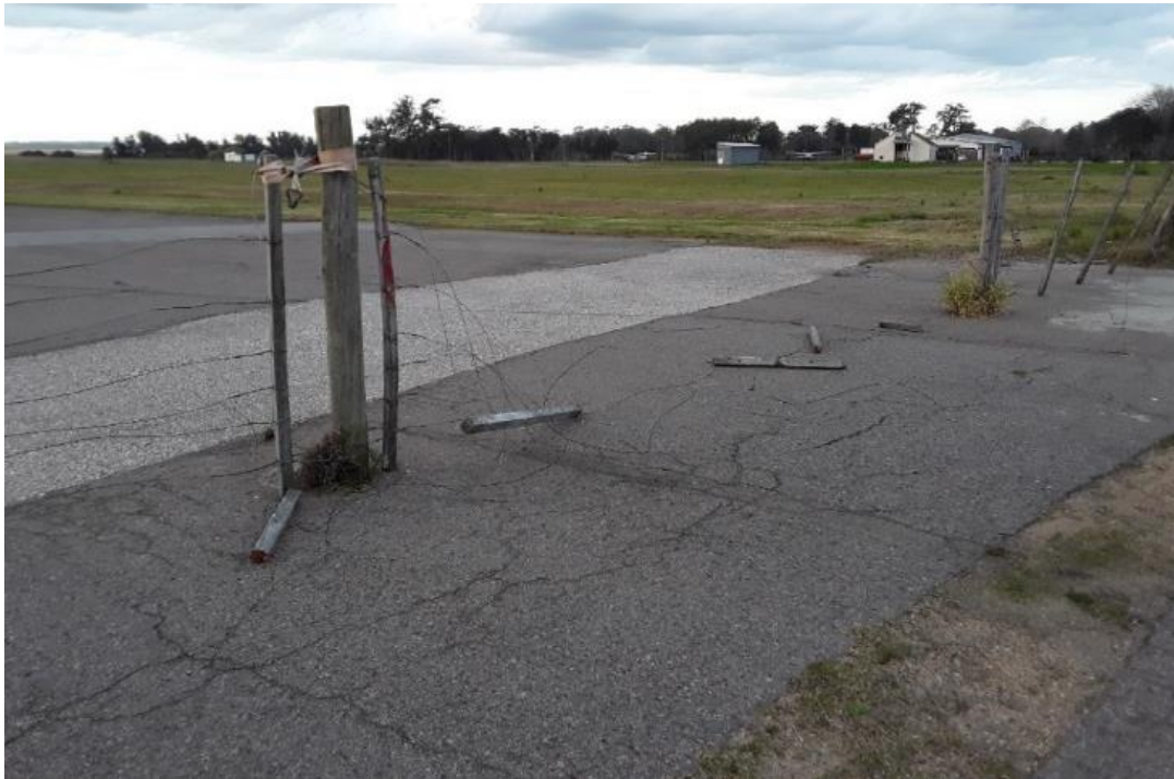
Imagen 5. Daños en el tejido perimetral del Aeródromo.
