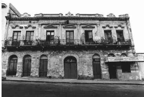
Fachada del Medio Mundo previo a su demolición durante los años 70. La imagen muestra el pronto deterioro que sufriría su fachada. Fotografía de Mario Schettini. Extraída de ADINOLFI, Laura, ERCHINI, Carina, op. cit., p 133.
