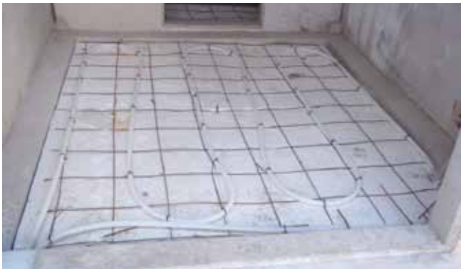
Cañería de losa radiante por donde circula el agua caliente.
