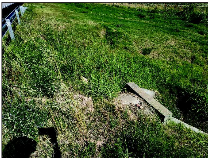
Ilustración 1 Erosión en faja sobre alcantarilla km29
