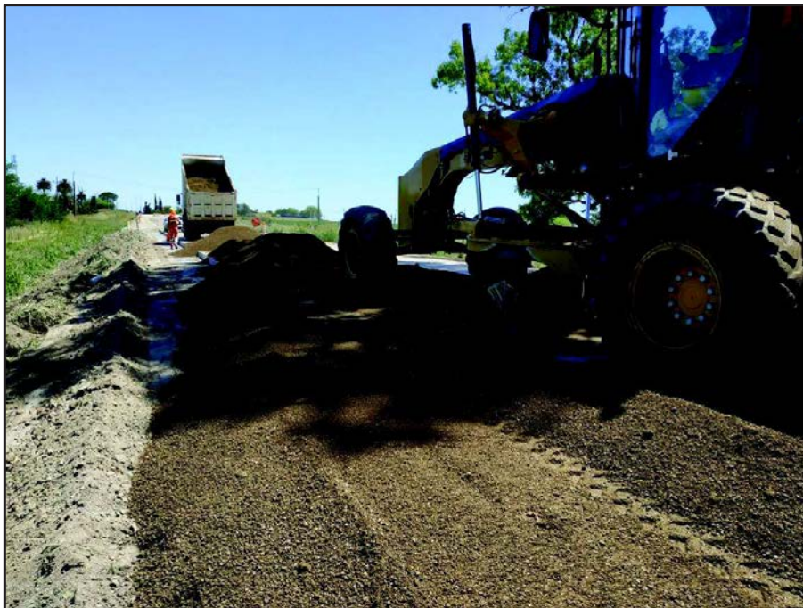
Ilustración 15: Recargo de banquina, Tramo 493, Ruta 55
