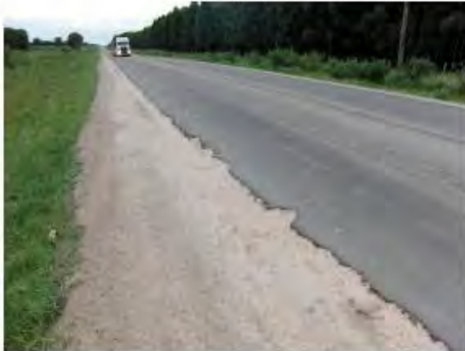
Foto 7: Ahueflamientos en ambas sendas y desprendimiento de pavimento en senda [-]. Sangría de material granular deteriorada con pérdida de borde.
