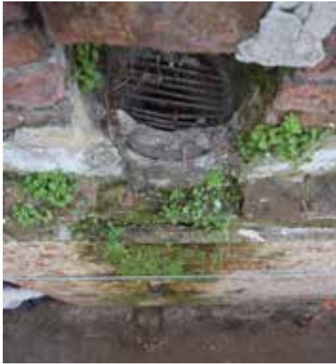
Fig. 37. Se observa en la azotea la rejilla de hierro colocada en la parte superior de la canalización, vivienda del siglo XIX, calle Sarandí, Ciudad Vieja. Caso n.º 13
