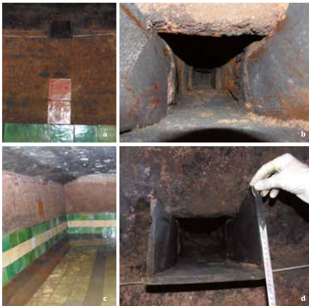
Fig. 39. Interior de la cisterna. 39a. Se observa debajo del punto de desagüe dos baldosas vidriadas, colocadas para evitar la erosión del revoque causado por el flujo del agua. 39b, c y d. Diferentes vistas de un punto de desagüe al interior de la cisterna. Calle 25 de Mayo, Ciudad Vieja. Caso n.º 5
