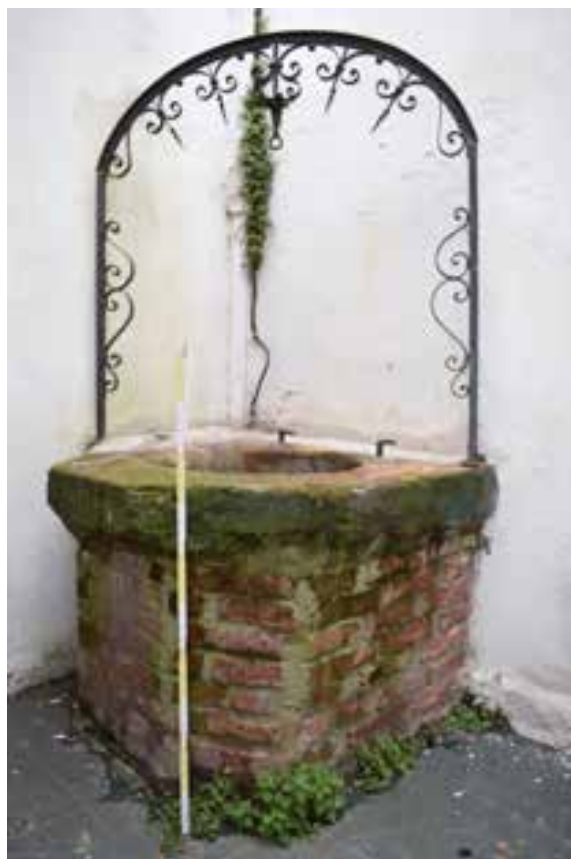
Fig. 58. Brocal con terminación superior de piedra gris local, en patio del almacén El Hacha. Calle Buenos Aires esquina Maciel, Ciudad Vieja
