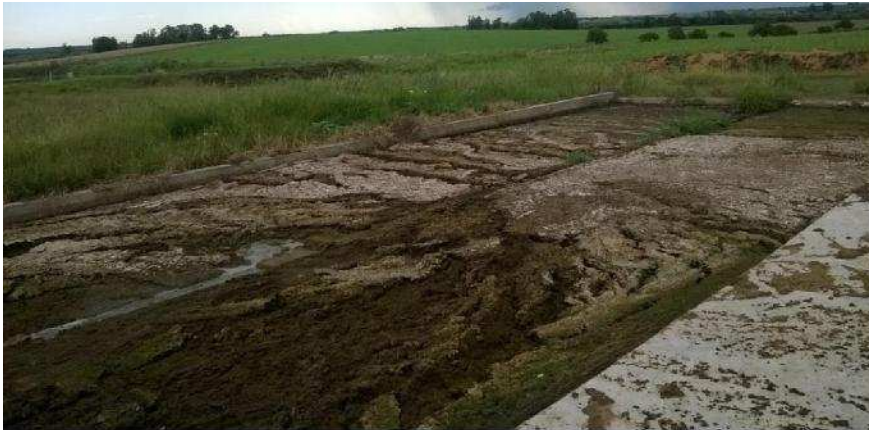
Figura 8. Ejemplo de un sistema de trampa / de separación colmada descargando los sólidos por donde deberían salir los líquidos.
