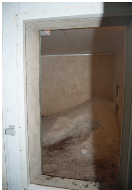
Cámara con fábrica de hielo en escamas que permite a los pescadores llevar hielo a los campamentos y asegurar la conservación del pescado.
