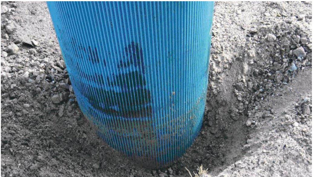
Fig. 27. Pozo sin cementar
