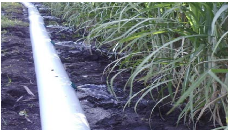
Riego de caña de azúcar con el sistema de mangas y compuertas regulables
