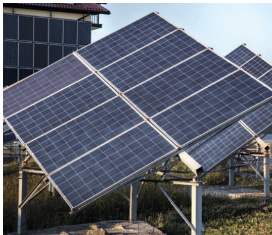
Imagen 4. Planta solar fotovoltaica de mediano porte
