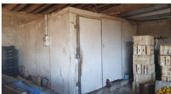
Imagen 1. Cámara de frío de isopanel
