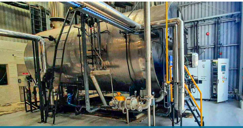
Caldera dual de biogas, Estancias del Lago.
