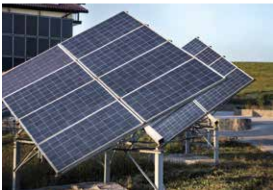
Figura 6: Paneles solares fotovoltaicos
