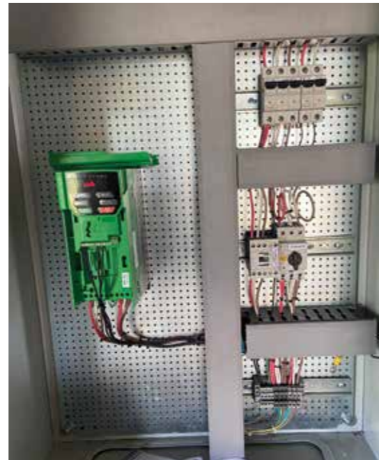
Imagen 2. Variador de frecuencia para equipos de refrigeración
