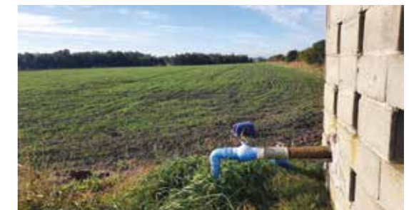
Imagen 3. Toma de la instalación de bombeo para riego
