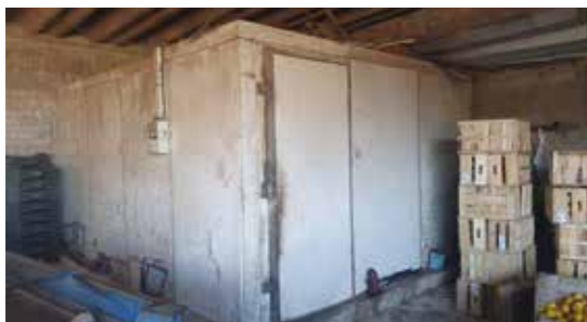
Imagen 1. Cámara de frío de isopanel
