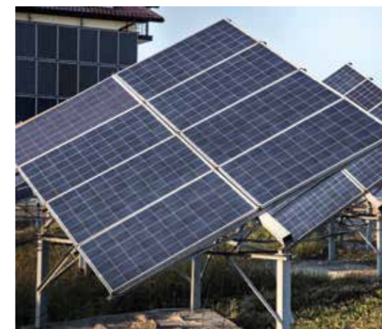
Imagen 4. Planta solar fotovoltaica de mediano porte
