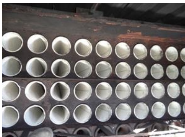
Imagen 01 – conjunto de filtros de mangas en una generadora de energía a través de quema de biomasa en Brasil
