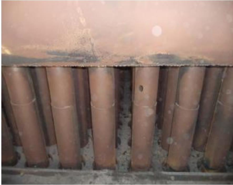
Imagen 02 – Tubería de un multiciclón en uso.
