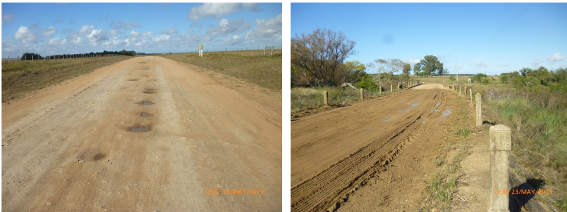
Gráfico 5-4: Deterioro superficial de la Ruta 41: Tramo 1 (izquierda); Comienzo del Tramo 2 (derecha)
