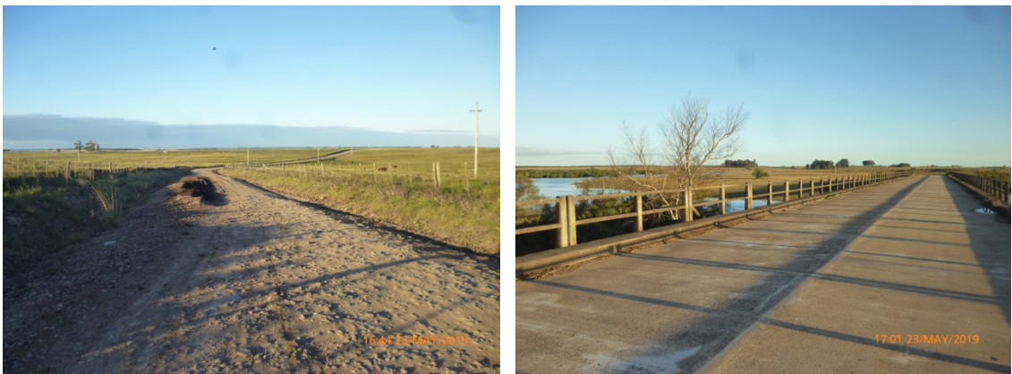
Gráfico 5-4: Ruta 59: deterioro en progresiva km 7 (izquierda); puente sobre el A° Malo (derecha)
