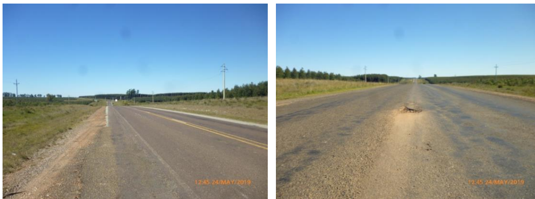
Gráfico 5-7: Deterioro superficial de la Ruta 90
