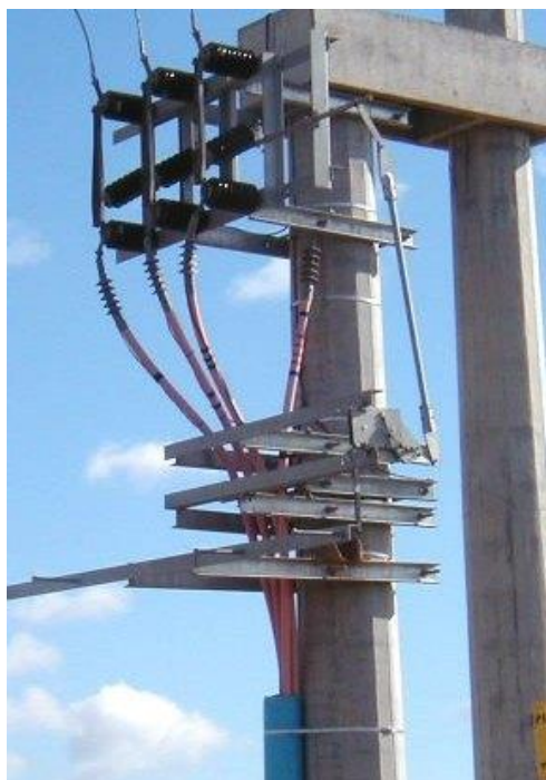
Foto 4: Terminales de cables en instalación intemperie
