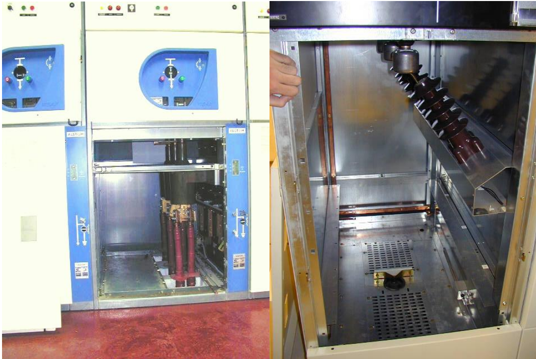
Foto 1: Compartimientos de cable aislamiento en aire con terminales convencionales (no apantallados)
