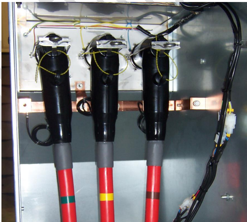
Foto 2: Compartimientos de cable con terminales apantallados tipo enchufables.
