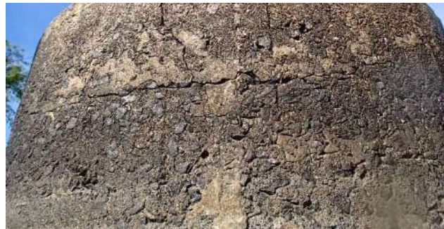
Fisura superficial Pilar # 22
