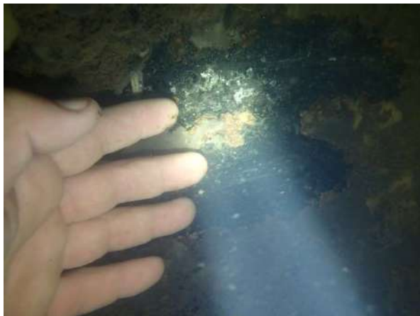
Camisa metálica expuesta
