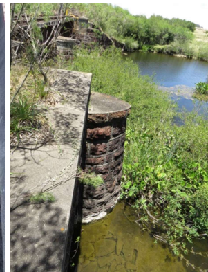
Fracturas en la carpeta Estribo, Arco Norte
