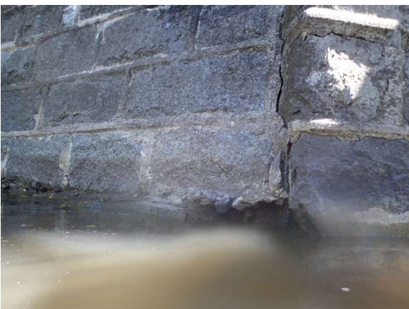
Fractura en estribo Norte borde este
