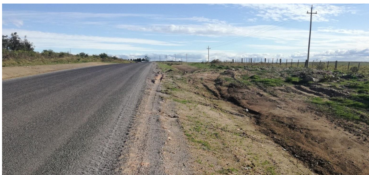
Foto 13.1-2 Vista 3 - Ruta 7 Cuneta interrumpida
