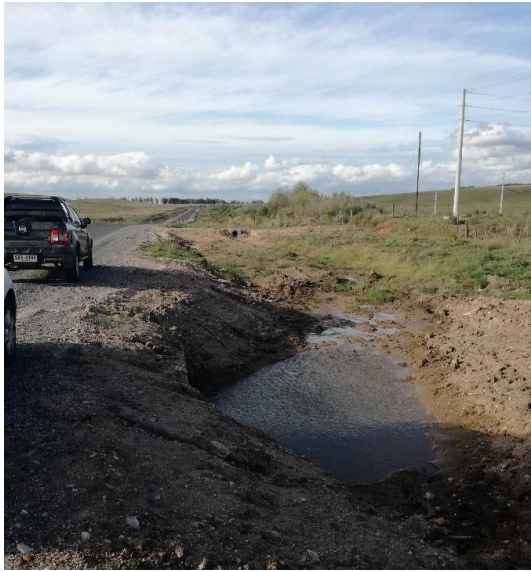
Foto 13.2-1 Vista 4 - Ruta 7 Agua estancada en alcantarilla
