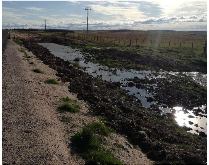
Foto 13.2-2 Vista 5 - Ruta 7 Agua estancada en alcantarilla
